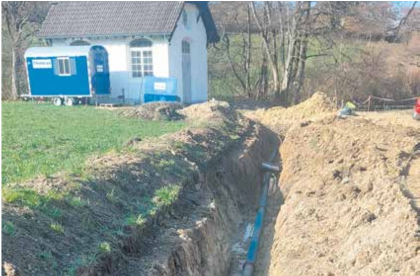
Conduite reliant la STAP, Chemin de Loville
