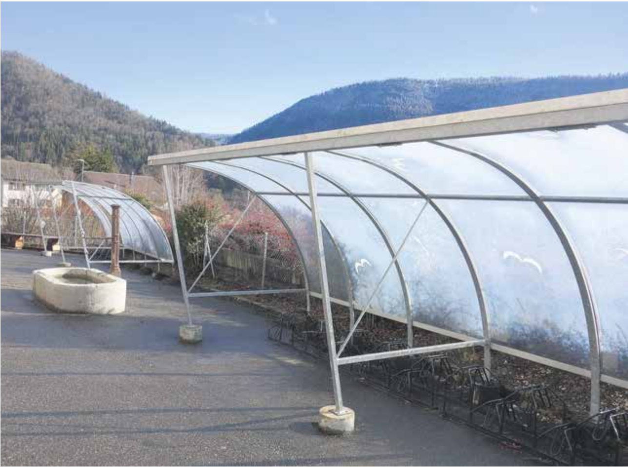
Il manque des plaques sur les abris à cycles qui seront rénovés, tandis que la fontaine sera entourée de bancs
