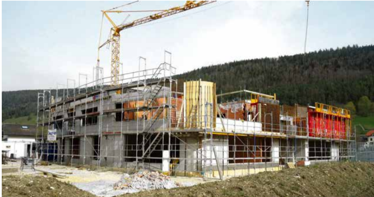
Le chantier de la Maison de l'Enfance mardi, donc à la veille de couler la dernière dalle
