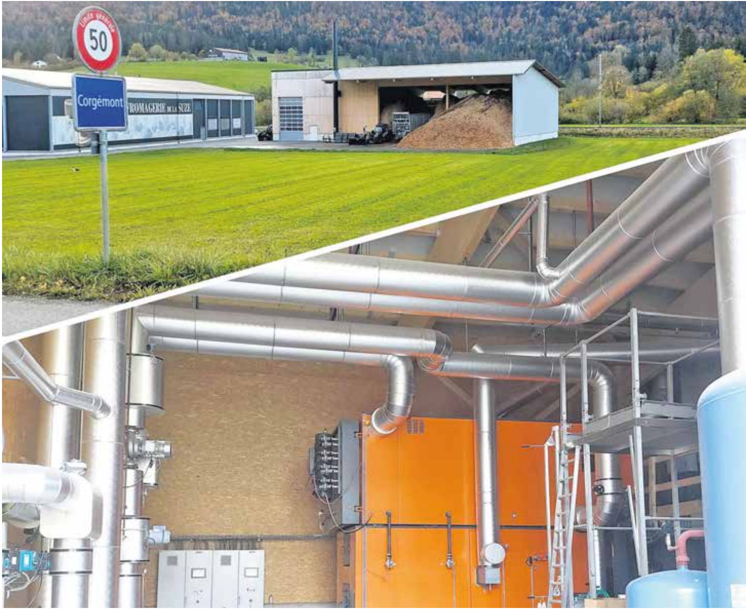
Energie Corgémont SA, devant et dedans
