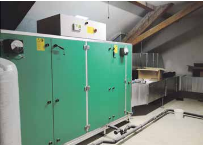
Dans les combles, les installations techniques de chauffage et d'aération
