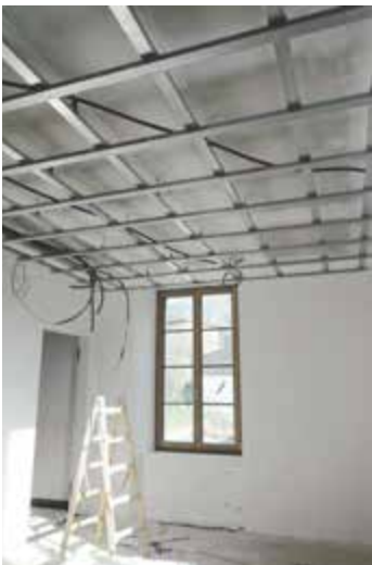
Les plafonds des salles de classe sont non seulement anti-feu et conçu pour un effet phonique
