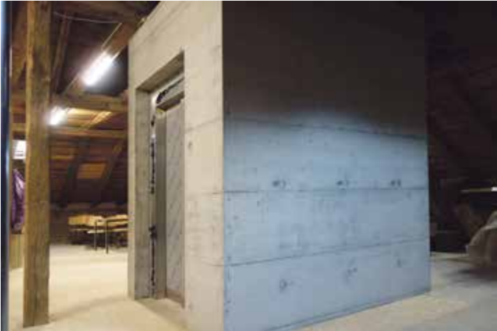
L'ascenseur desservira tous les niveaux du bâtiment
