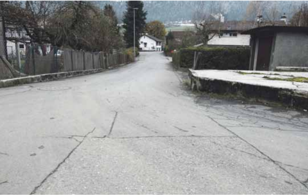
Il est nécessaire d’intervenir sur la rue de la Châtelaine, dont la portion Nord est très mal en point
