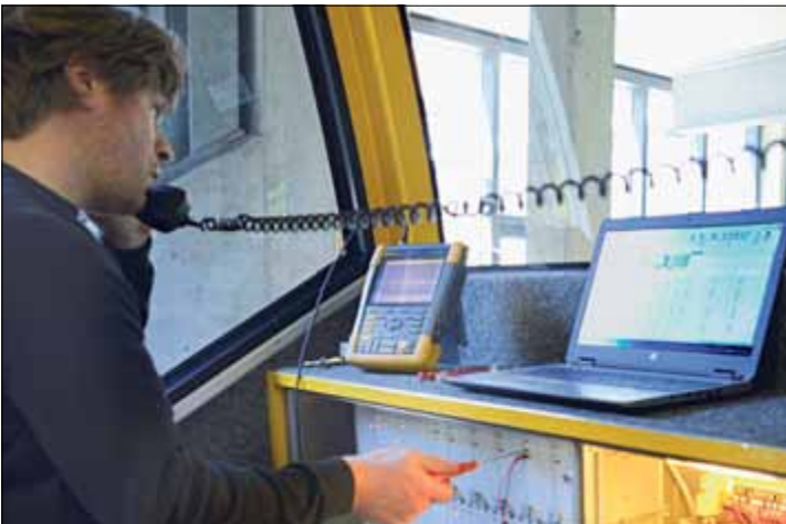
Composants mécaniques, commandes électroniques, parties électriques : l'intégralité de l'installation a été révisée la semaine dernière (photos Pierre Pfiffner/funi)
